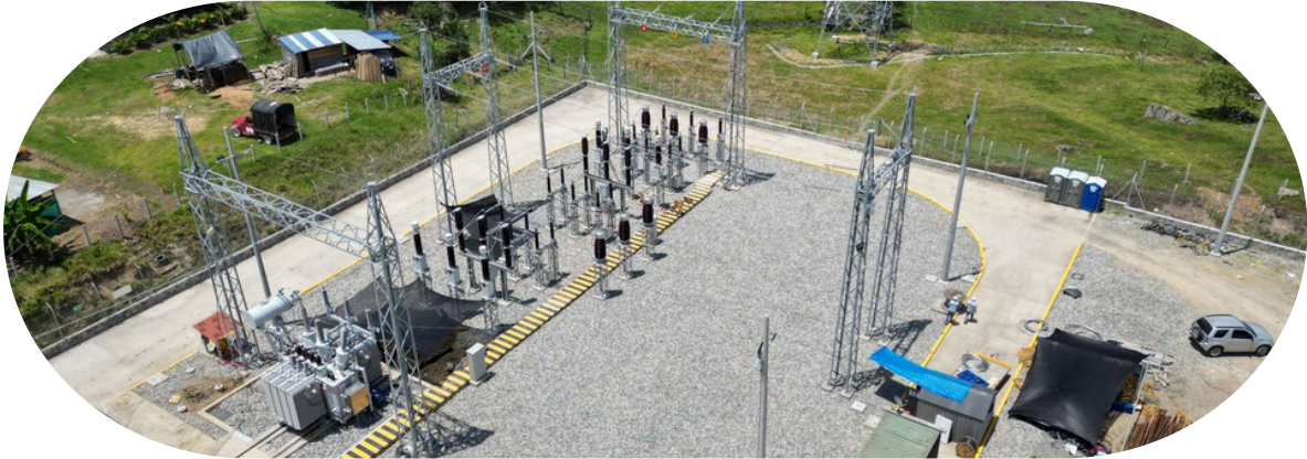
IMAGEN 15 - SUBESTACIÓN SEGOVIANAS LA PLATA (H)
