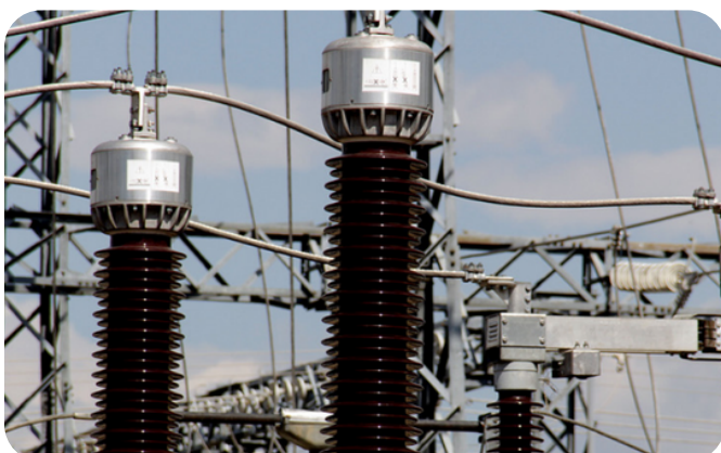
IMAGEN 22 -EQUIPOS DE SUBESTACIÓN
