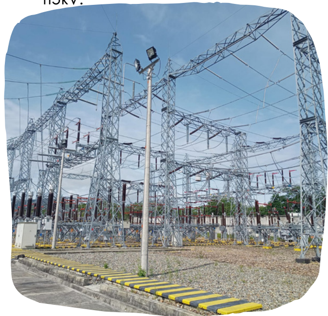
IMAGEN 5 - SUBESTACIÓN ALTAMIRA 230/115/34.5/13.8 KV
