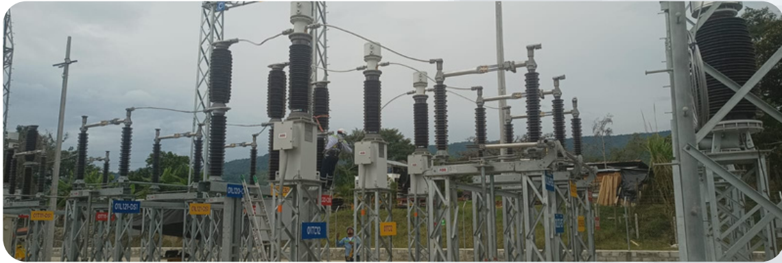
IMAGEN 10 - SUBSTACIÓN SEGOVIANAS LA PLATA (H)
