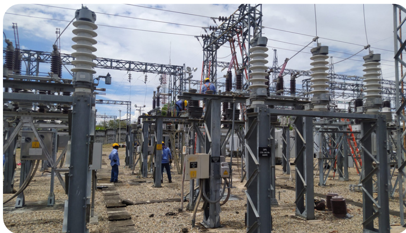
IMAGEN 14 - EQUIPOS DE SUBESTACIÓN
